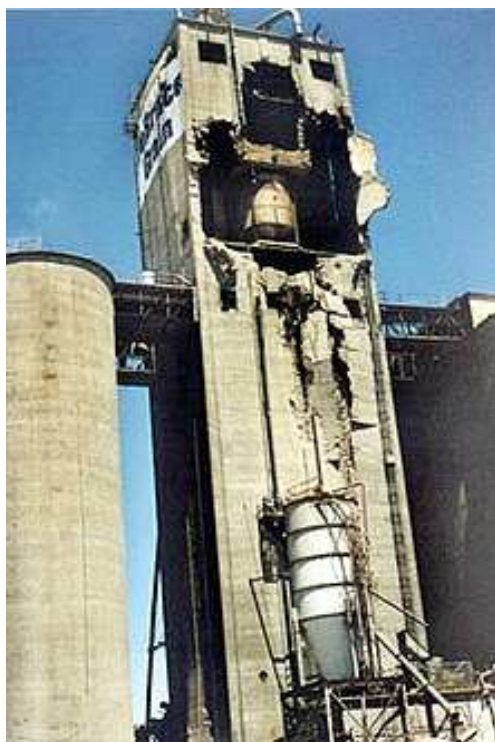
Silo à grains de type tour après une explosion
